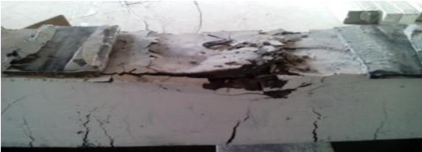
شکل ۲- تیر B1 پس از بارگذاری و نحوه شکست
