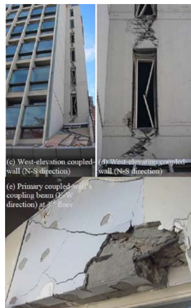
شکل ۱: ساختمان هفت طبقه ساخته شده با دیوار برشی بتن مسلح در دهه ۱۹۶۰ با آسیب دیدگی مشخص در تیر کوبله [۵].
