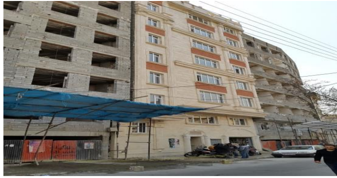
تصویر شماره 2- سه ساختمان 10 طبقه در خیابان استاد حسن بنا جنوبی فروردین 1394
