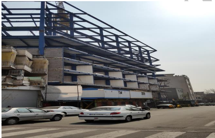
تصویر شماره 7- ساختمان 10 طبقه تجاری بدون داشتن پارکینگهای مورد نیاز
