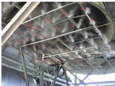
شکل ۱۶: نمونه نازل‌های اسپری نصب شده
