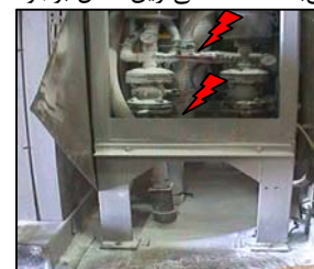
شکل (۶): ریزش پودر PVC در لوله های انتقال دهنده پر کن
