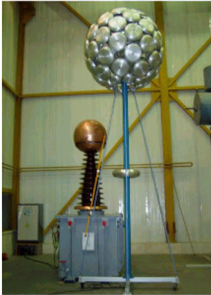
شکل ۴- ب: ترانسفورماتور آزمایشگاهی فشار قوی.
